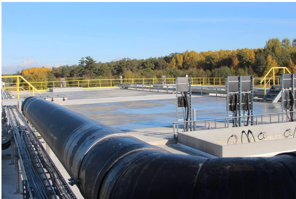
Foto 6.2 Muuga reoveepuhasti protsessimahutid (kinnised, ventileeritud)
