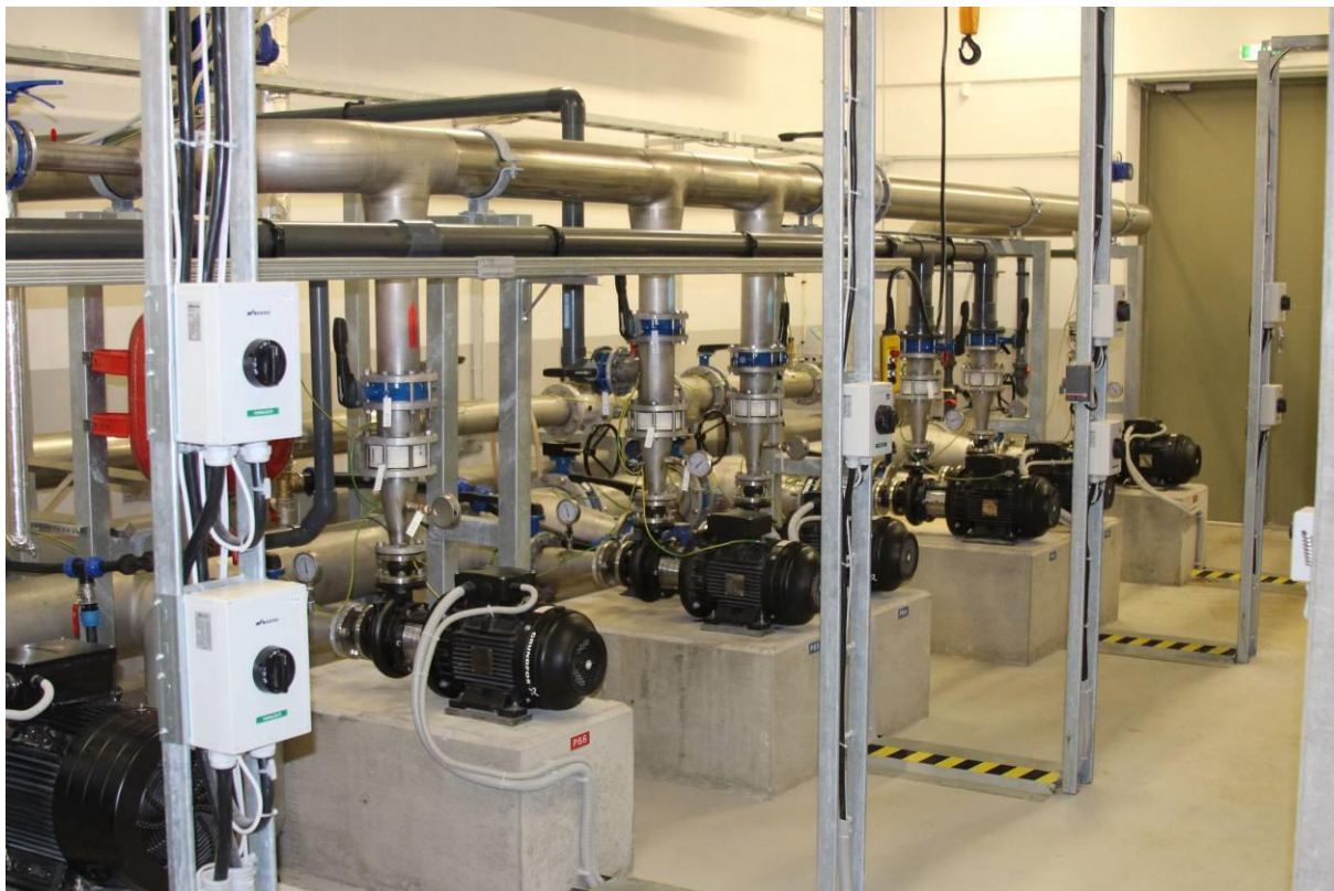
Foto 5.4. Viimsi veetötlusjaama II astme pumbad
